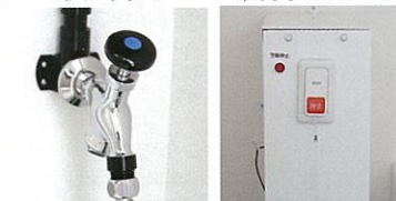
ワンタッチ水栓 非常時は外部に
